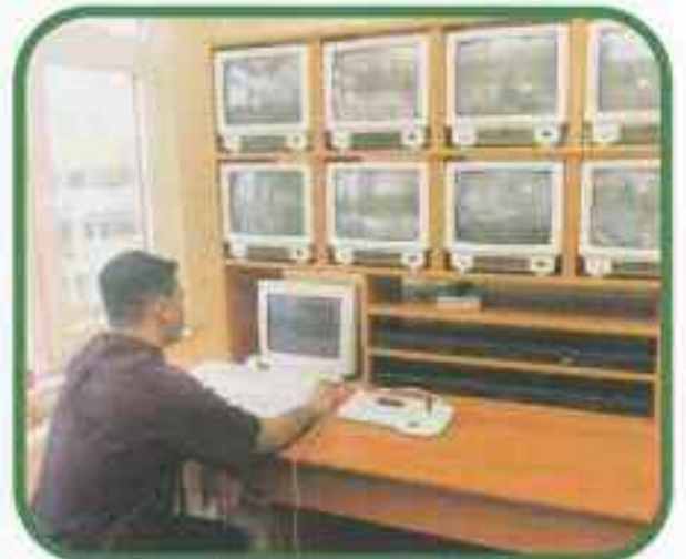
Güvenlik kontrol merkezi
